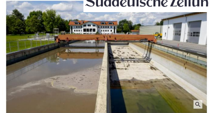
Im Klärwerk in Neufinsing wird das Abwasser in mehreren Becken nach und nach gereinigt. (Foto: Photographie Peter Hinz-Rosin)
